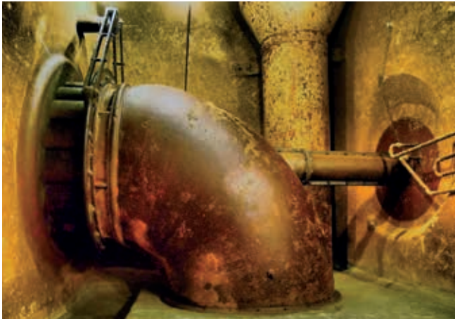
Le site abrite la plus ancienne centrale électrique sur l'Orbe (1891)
